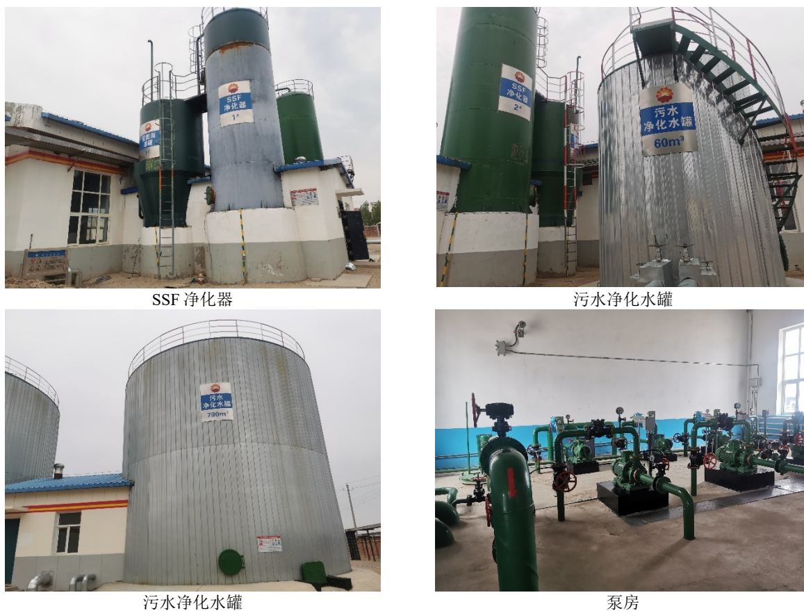
图 3.2-9 德二联含油污水处理站现状照片
