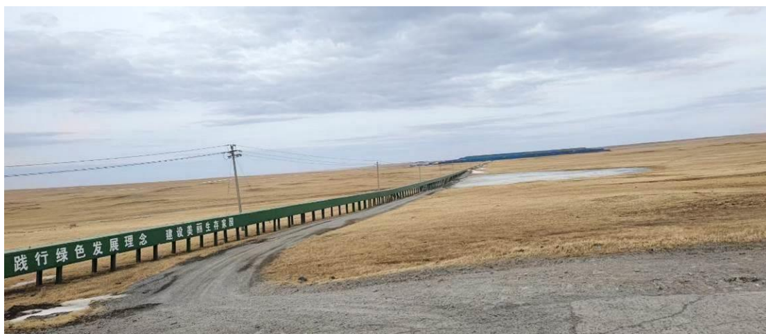
图 3.4-1 尾矿浆及压滤水输送管廊实景图
