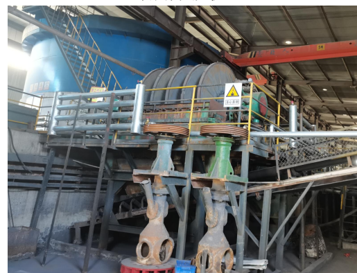
精矿过滤机及浓密罐
